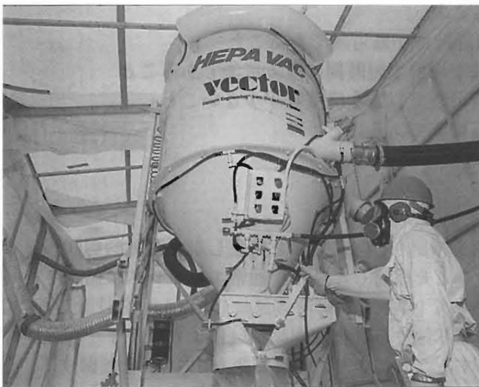
写真3 HEPA用大型真空装置
